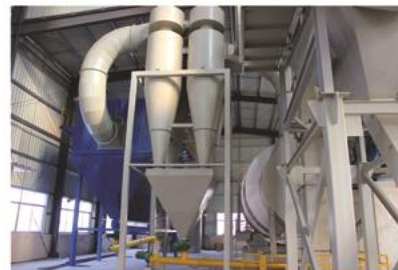
▲ 除尘行业 Dust removal industry
